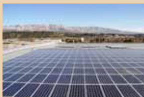
Panneaux photovoltaïques © photo Infotexte, Vincent Roullier
